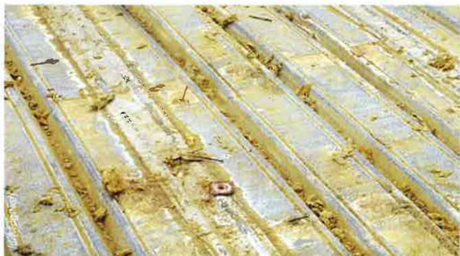
Rénovation de toiture avec élément porteur existant en bac acier d'un local classé en très forte hygrométrie : rouille blanche de l'acier et fixations mécaniques fortement corrodées.
